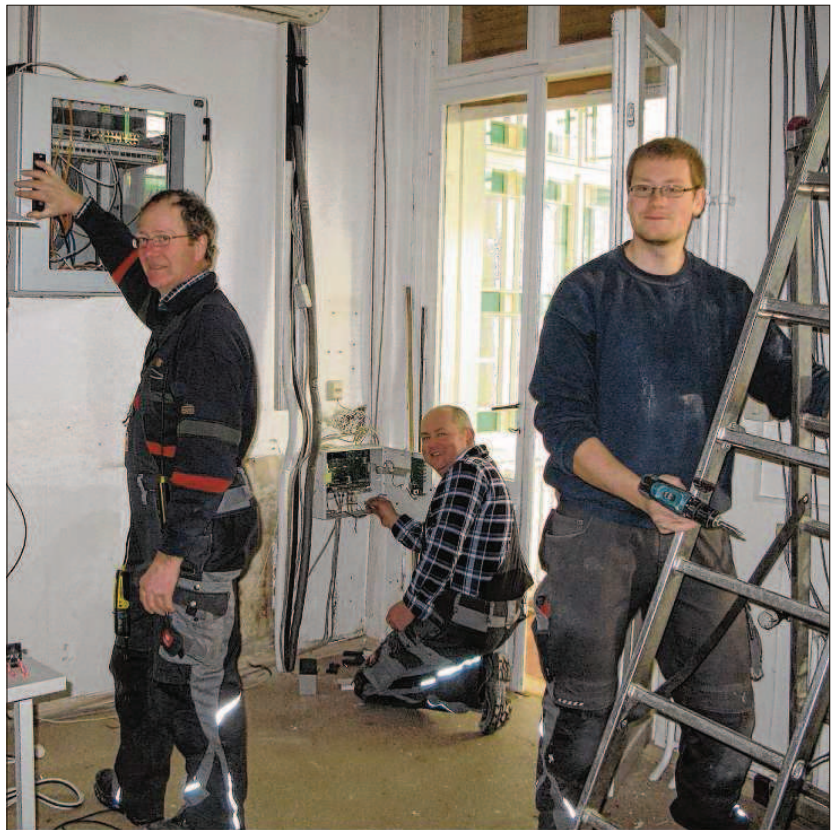
Eingespieltes Tulight-Team: Die Elektro-Installateure Volkmar Lüdtkte, Heiko Marggraf und Azubi Franz Scholz (von links) klemmen in dieser Woche die Räume in der Fürstenwalder „Villa Germania“ stromlos, damit die Sanierungsarbeiten beginnen können. Fotos (3): Cornelia Link
